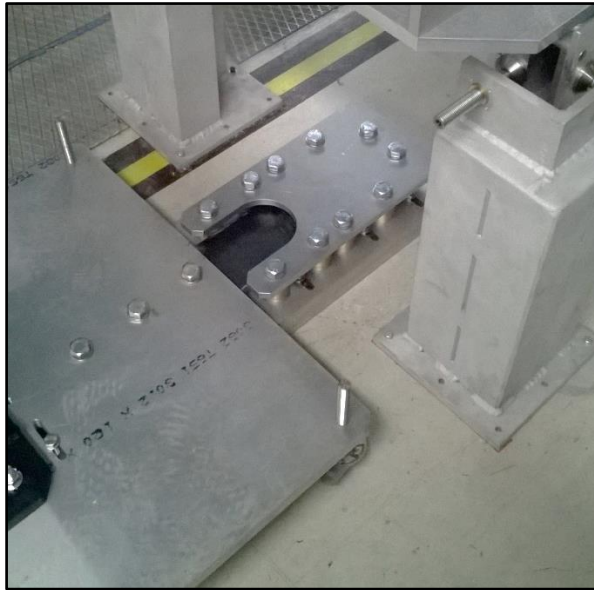
Figura 4.16 Macchina di emergenza allineata e centrata rispetto la battuta meccanica.
