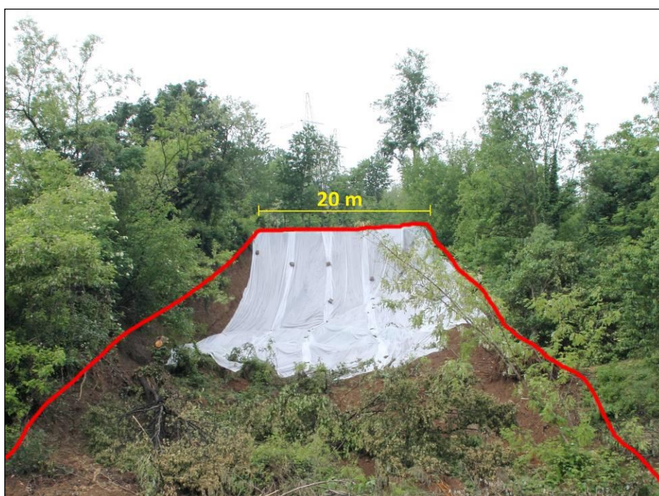
Fig.8- Superficie di rottura della frana. In rosso sono evidenziati il coronamento e i fianchi della frana.
