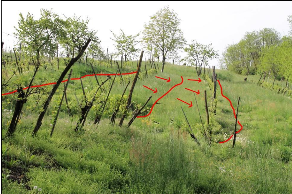
Fig.7- Scarpate secondarie della frana.
