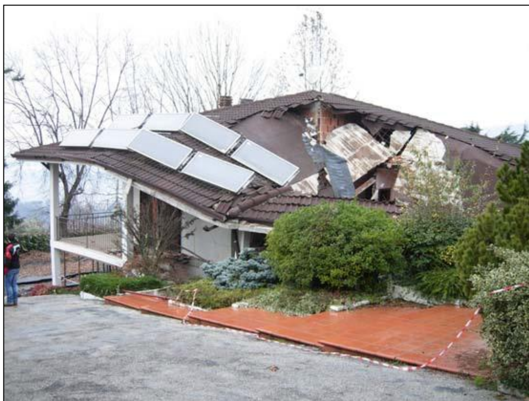
Fig.5- Cedimento dell'abitazione sul lato est.
