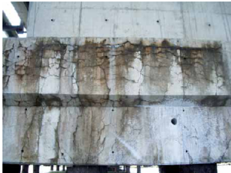
Fig. 1.2: degrado dovuto reazione ASR
