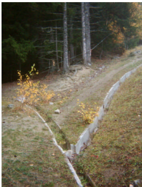
Figura 1.14 - Canaline varie ai bordi della pista da sci. (Bormio, impianto Vallecetta, 2005)
