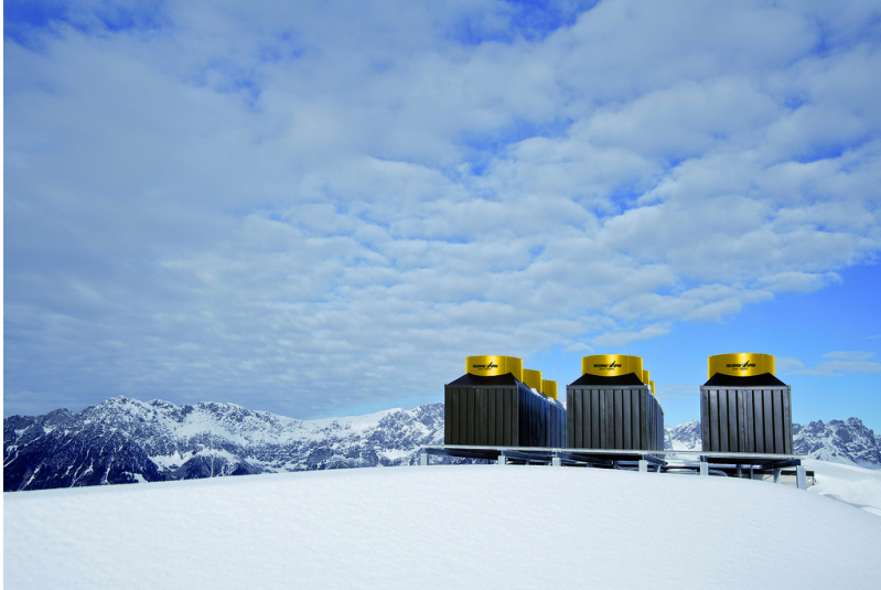
Figura 1.17 - Esempio di torri di raffreddamento - Cortina d'Ampezzo (BL)
