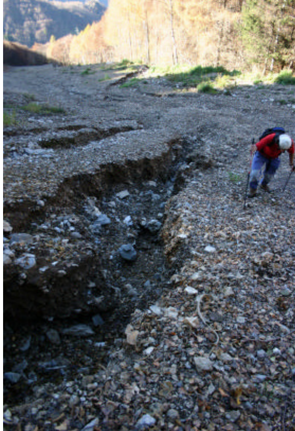
Figura 1.2 - L'assenza di inerbimento delle piste provoca erosione superficiale e piccoli dissesti. Pista "Bobbio" Barzio (LC), 2005
