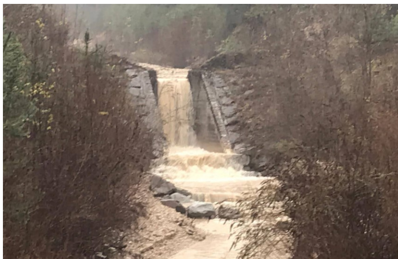
Foto 16: Briglia filtrante ostruita dal detrito (fonte: Servizio Bacini Montani TN).
