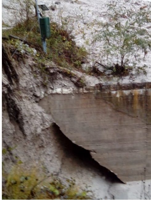
Foto 15: Scalzamento della briglia n.13 (fonte: Servizio Bacini Montani TN).
