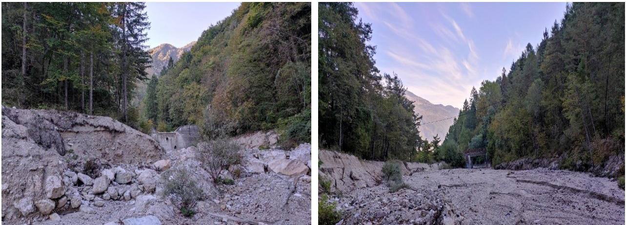
Foto 24: Sponde laterali instabili con vegetazione nel settore 2, la prima a valle della briglia °13, la seconda a monte del ponte della strada provinciale.
