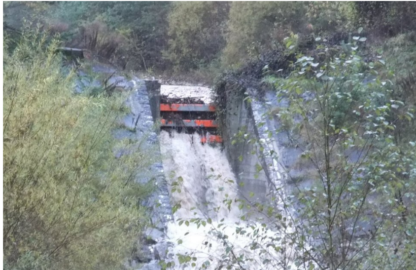
Foto 10: Briglia filtrante ostruita dal materiale legnoso durante l'evento del 2012 (fonte: Servizio Bacini Montani TN).
