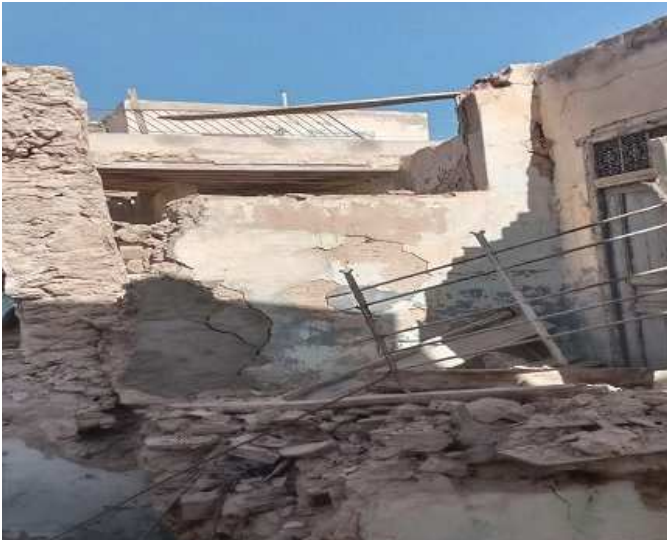
Figure 14. Journal DirectInfo, Photographie d'une maison effondrée, Médina de Sfax, Tunisie, 5 décembre 2022
