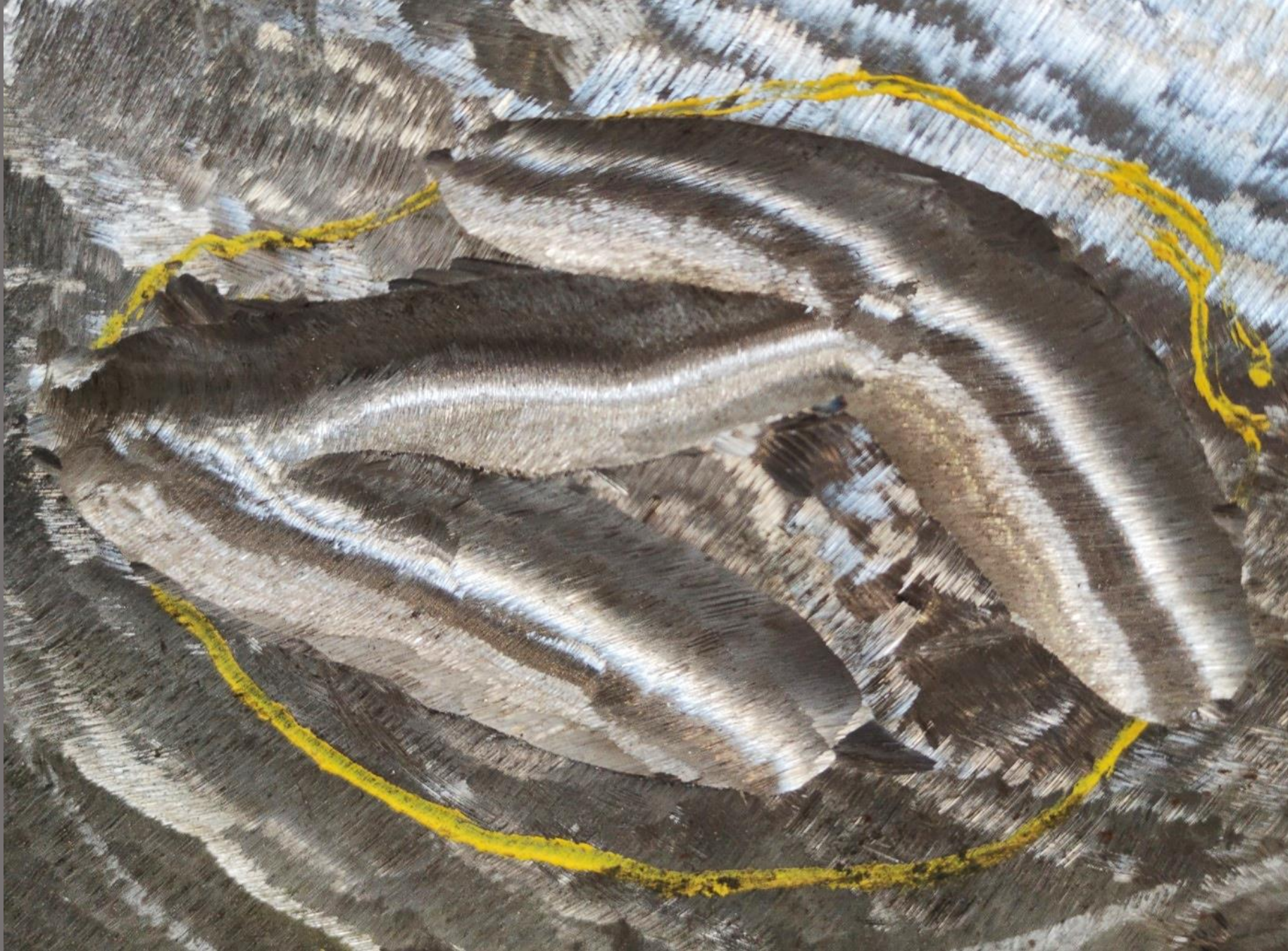
Difetti asportati tramite arc-air e molati; in seguito si faranno dei CND e una saldatura di riparazione.
