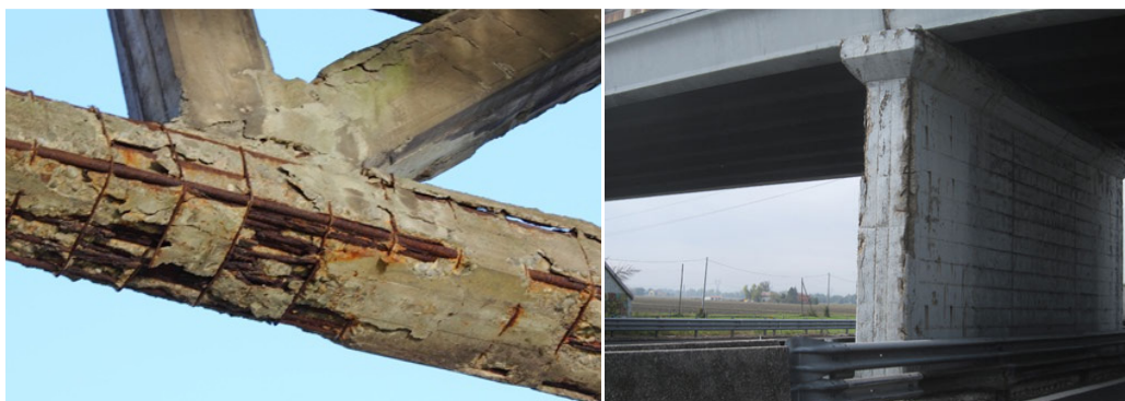
Figura 2.1 – Effetti della corrosione.
