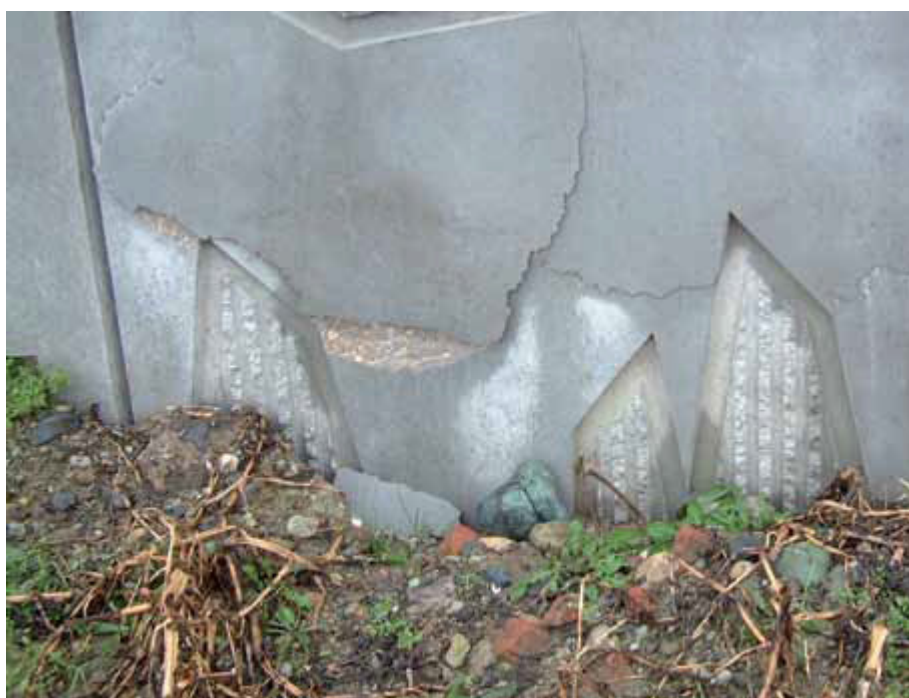
Figura 1.7 - Degrado dovuto al gelo.
