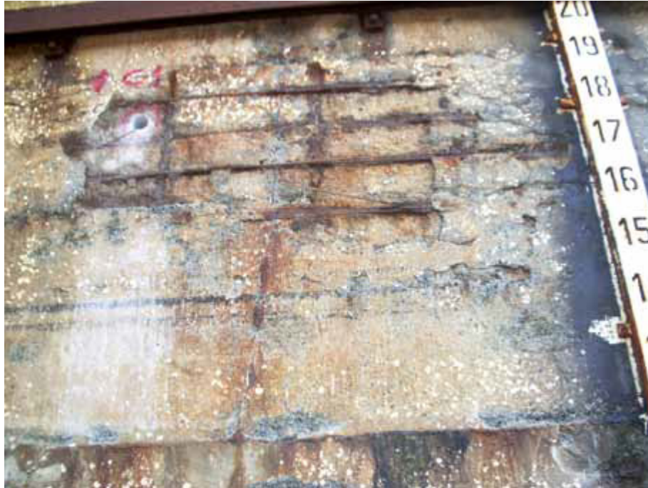
Figura 1.5 - Degrado dovuto all'attacco dei cloruri.
