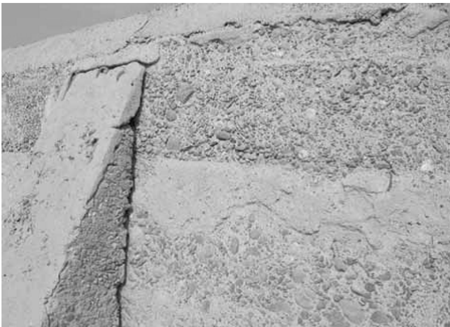
Figura 1.3 - Effetto del dilavamento su una parete in calcestruzzo.
