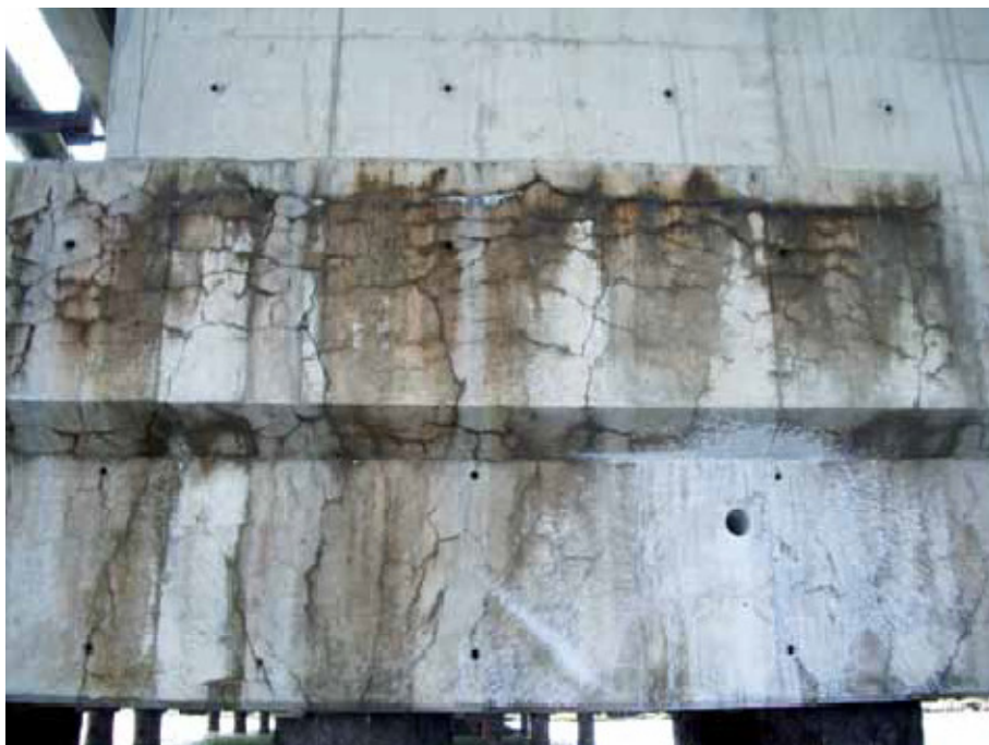
Figura 1.6 - Degrado dovuto alla reazione degli alcali-aggregati.
