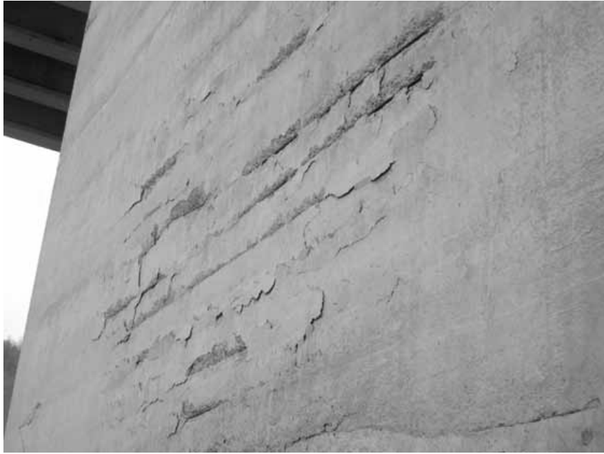
Figura 1.2 - Struttura degradata a causa della corrosione dovuta alla carbonatazione.
