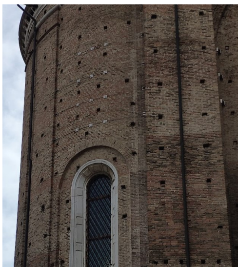
Figura 2.4.2: Cavi in acciaio presenti lungo la faccia esterna dell'abside nord.
