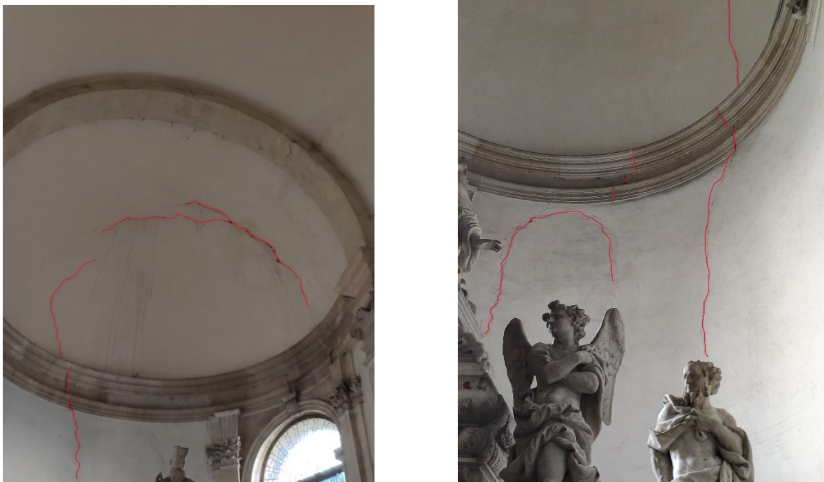
Figura 2.3.1: Quadro fessurativo nella cappella a Ovest del transetto di San Luca.
