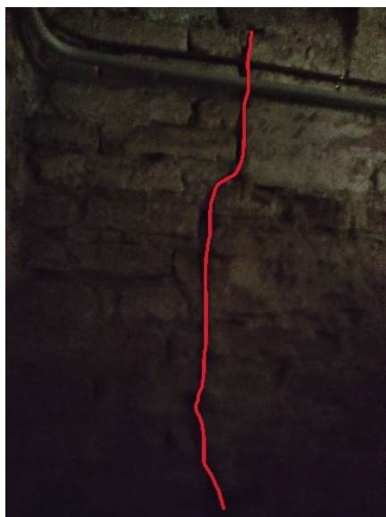
Figura 2.3.5: Fessura di una muratura portante nel cavedio della cappella ovest del transetto di S. Luca.
