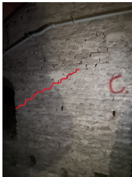
Figura 2.3.4: Fessura di una muratura portante localizzata al di sotto del transetto di S. Luca.
