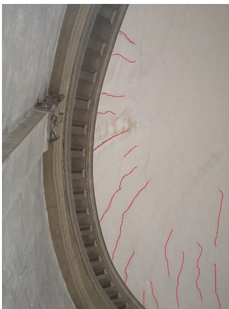
Figura 2.3.2: Quadro fessurativo del presbiterio.
