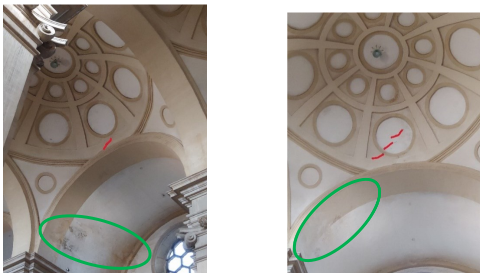
Figura 2.3.3: Fessure e degrado navata centrale.
