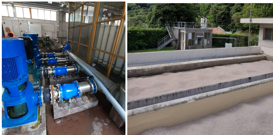
Figura 6.7 Destra: impianto di filtrazione costituito da quattro filtri a sabbia. Sinistra: sala pompe di sollevamento. (Fonte: Etra, 2022)
