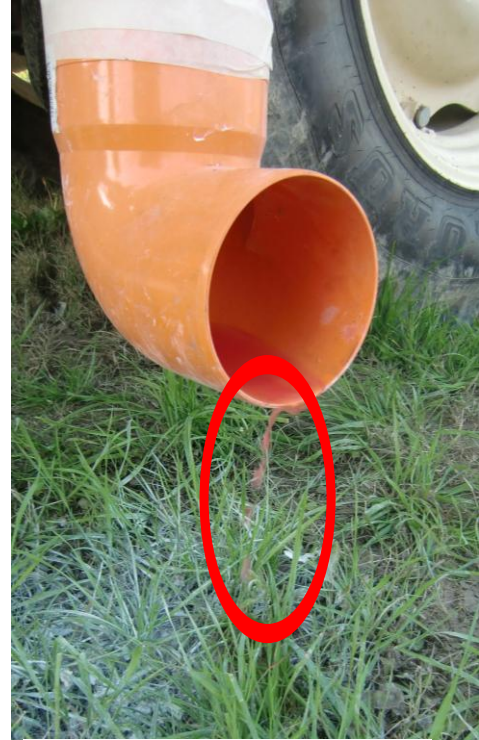
Foto 30: Gocciolatura particolato in uscita da dual pipe con acqua e vortice
