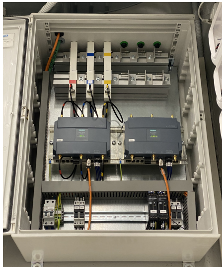
Figura 3.3: Quadro elettrico APs
