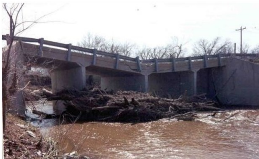
Figura 13: accumulo di materiale legnoso presso i piloni di un ponte (Lenzi, 2022-2023)
