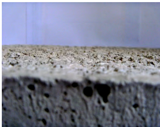
Figura 4.2: particolare superficie lastra in calcestruzzo.
