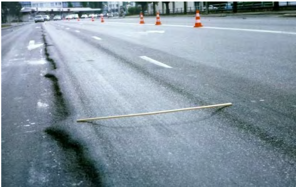
Figura 1.7: Esempio di danni sulla pavimentazione prodotti dall'ormaiamento.
