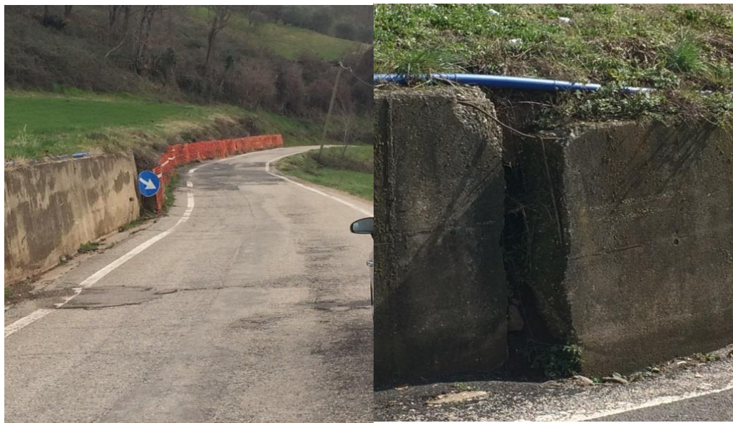
Fig. 3. 12 Danni alla strada e al parapetto in località Selva
