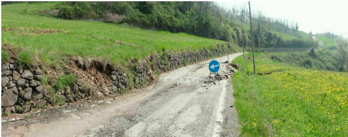
Fig. 3. 11 Danni alla strada in località Selva
