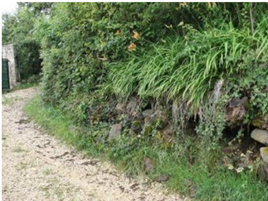
Fig. 4. 19 Danni alla strada di campagna in località Munari
