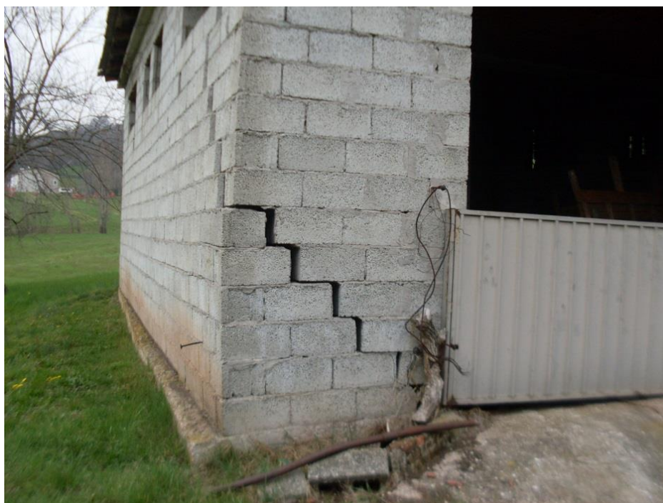
Fig. 3. 13 Danni alle fabbricazioni in località Piana Cattiva
