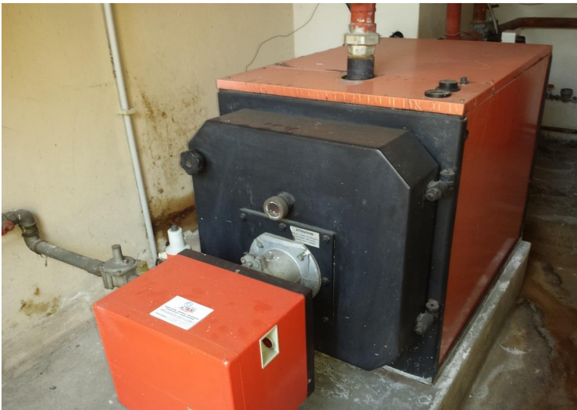
Figura 22: Fotografia della attuale caldaia a metano presente nella centrale termica
