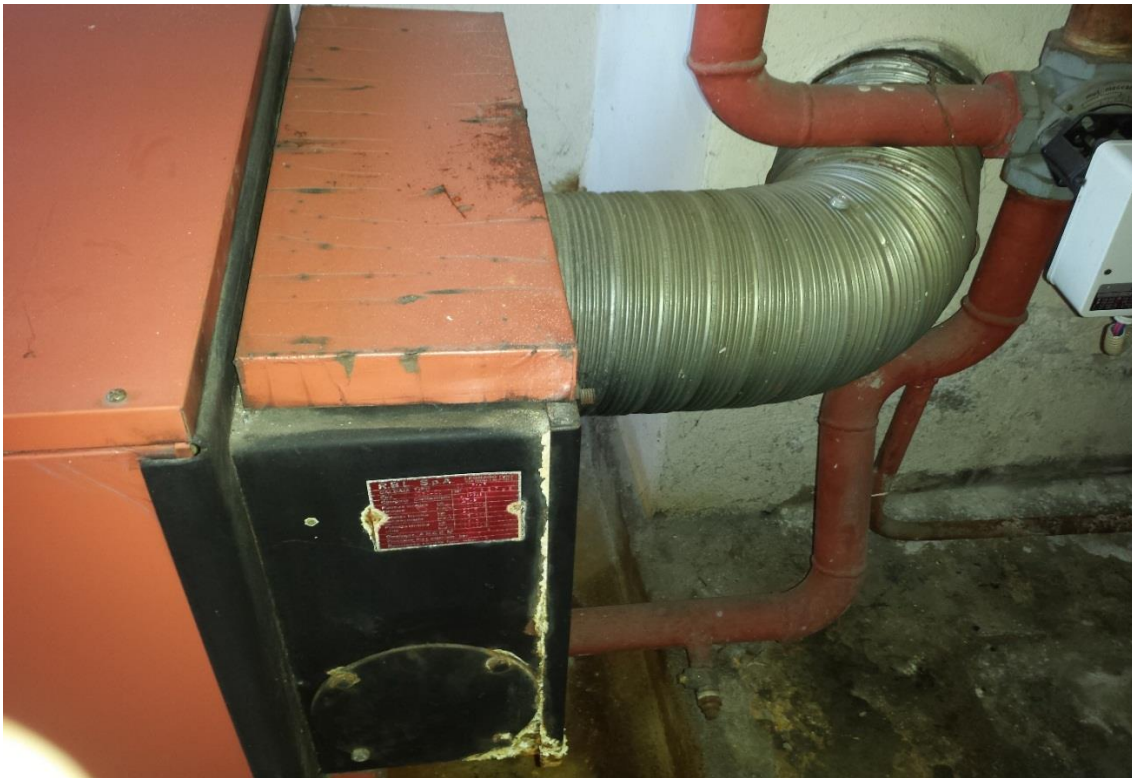
Figura 23: Particolare della targhetta e della tubazione di scarico fumi della caldaia
