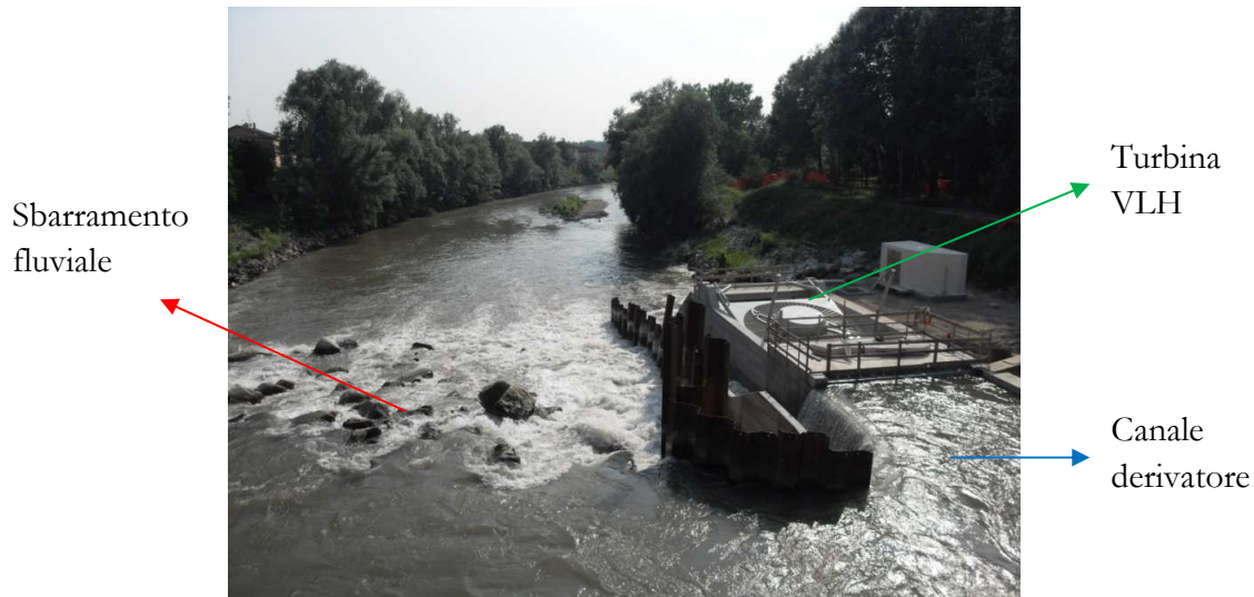
Figura 1- Vista dell'impianto VLH.
