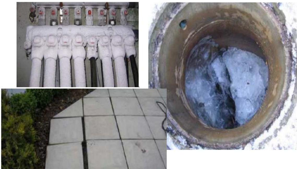
Fig. 5.8.2 Congelamento del terreno dovuto a sottodimensionamento dell'impianto
