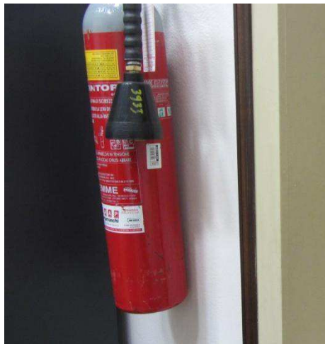
Fig. 4.64. Estintore a muro
