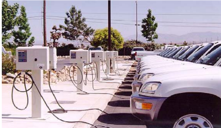
Fig. 6.6 Colonnine di ricarica per veicoli elettrici
