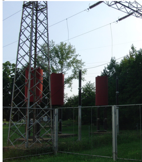
Fig.53: reattanze di contenimento (25 \Omega per fase)
