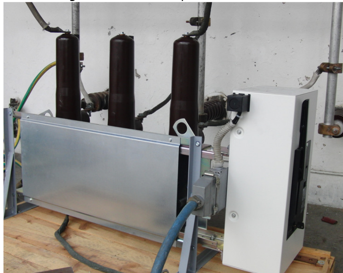
Fig.57: Interruttore di prova utilizzato in BT
