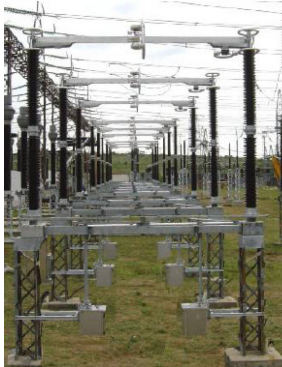
Fig.4: esempio di sezionatore ad interruzione centrale
