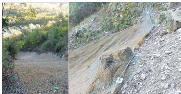
Figure 12: Rete stesa sul versante a protezione della S.S. 348
