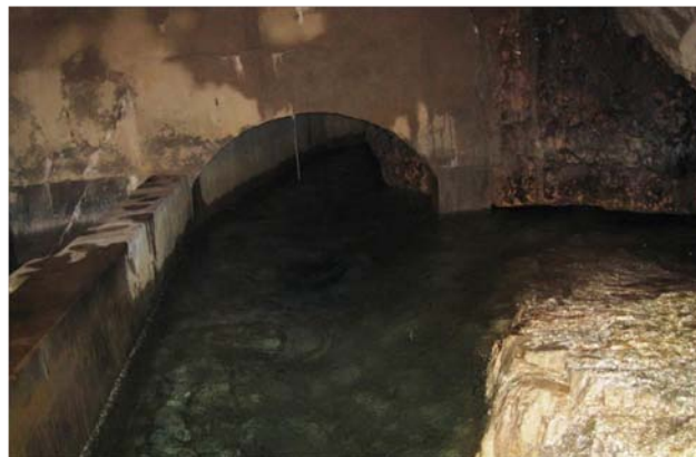
Figure 5: Sorgente del Tegorzo: l'opera di presa
