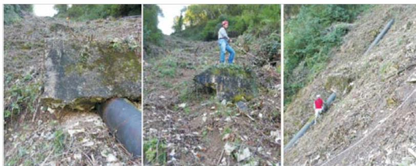
Figure 14: Immagini che evidenziano blocchi che gravano direttamente sulla condotta e il solco nel terreno dovuto al ruscellamento
