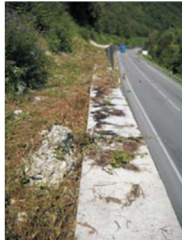
Figure 10: Masso arrivato fino al ciglio del muro di protezione della S.S. 348 (settembre 2012)
