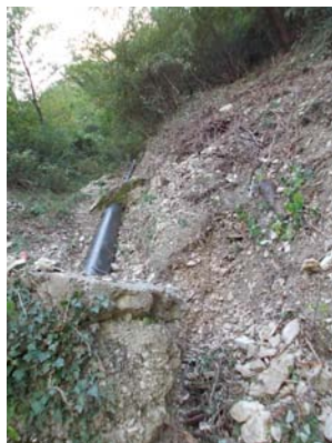
Figure 13: Immagine che testimonia l'affioramento a vista della condotta e dei blocchi di appesantimento
