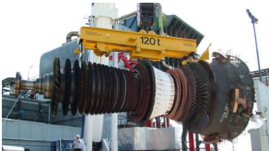
Figura 3-6 Vista del rotore in fase di manutenzione
