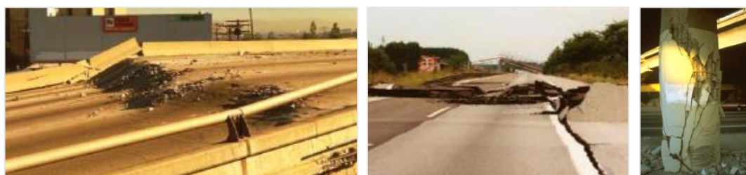
Figura 2.3 - Ponti: Danni di tipo esteso.
