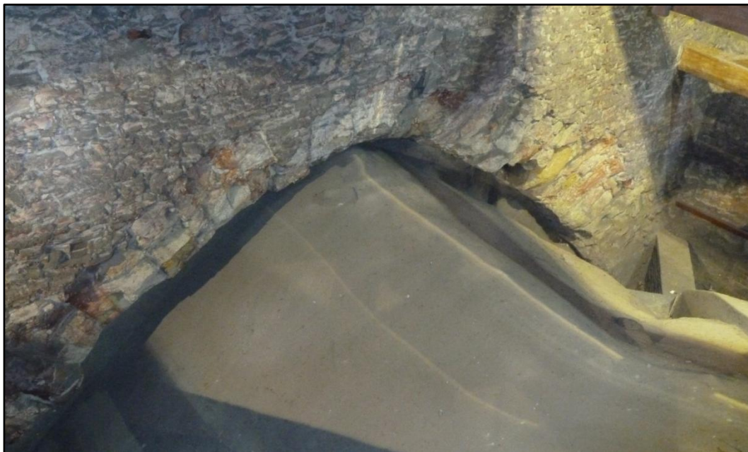
Fig. 14: estradosso della volta rivestito in malta di calce e arco di supporto della muratura superiore disconnesso dalla volta, impostato sulle colonne in pietra
