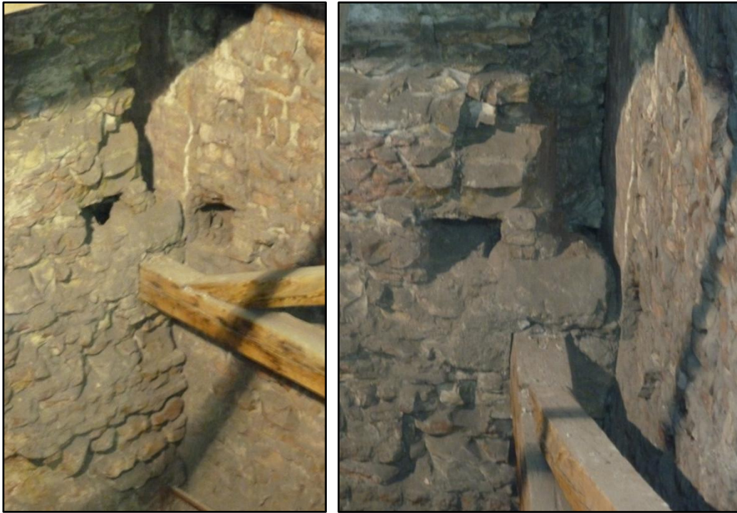
Fig. 19a-19b: sconnessione tra i muri ortogonali nell'angolo Sud-occidentale (muro del corpo centrale si accosta a quello dell'antica torre di fortificazione del '200)
