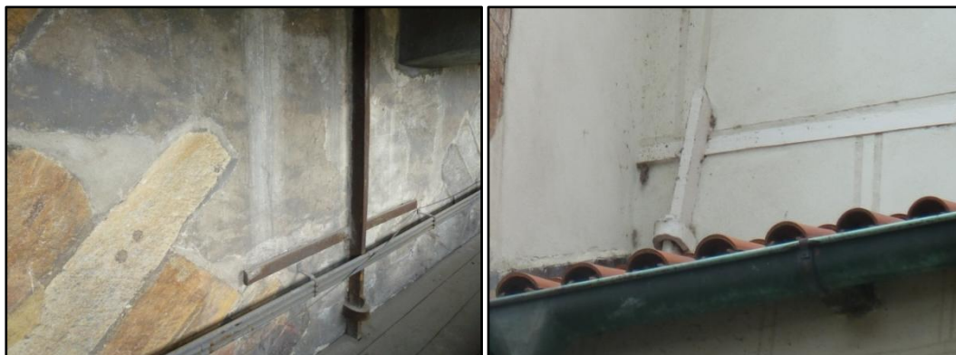
Fig. 17a-17b: dettaglio degli ancoraggi con paletti metallici delle catene dei muri perimetrali della Sala di Ladislao all'interno del ballatoio a Sud e superiormente a quello a Nord
