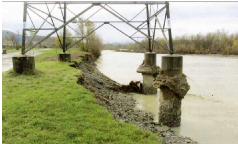
Fig 2.11– Esempio di erosione terreno alla base di un sostegno di una linea a 132 kV.
