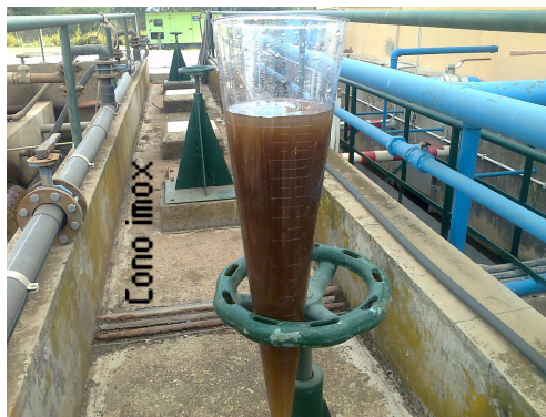
Figure 4.3, 4.4, 4.5 e 4.6: vasca di grigliatura; vasca di ossigenazione; vasca di sedimentazione; vasca di disinfezione; cono imox.
