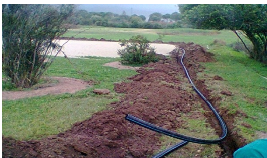
Figura 3.16: posa del tubo. In questa fase il tubo deve essere ancora saldato con il tubo dell'irrigazione del green della buca 15. La parte in sabbia che si vede è l'ampliamento del vivaio.
