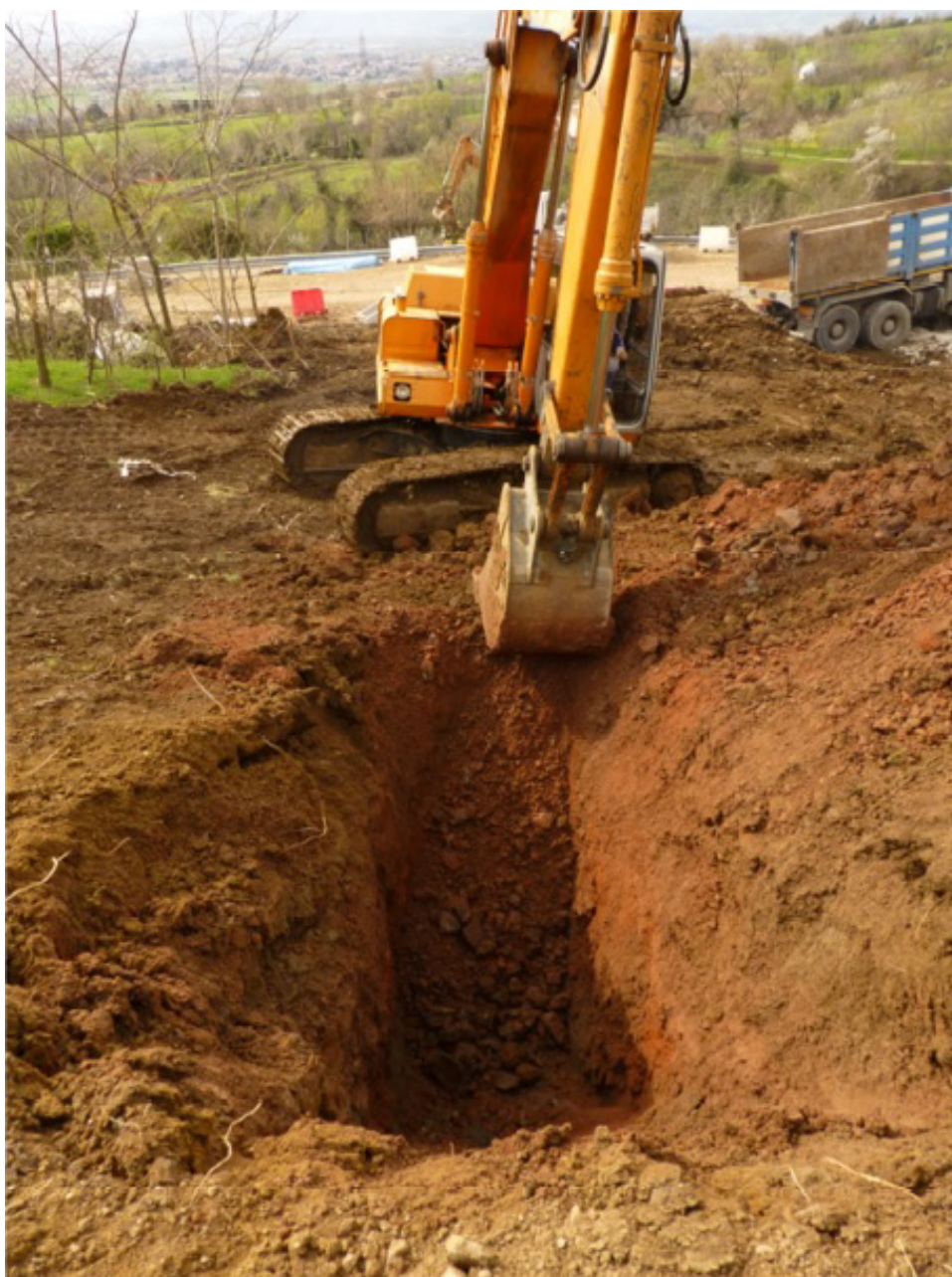
Figura 12: Fase di rimozione del terreno con l'ausilio di macchina escavatrice (Fonte: Toaldo, 2014).
