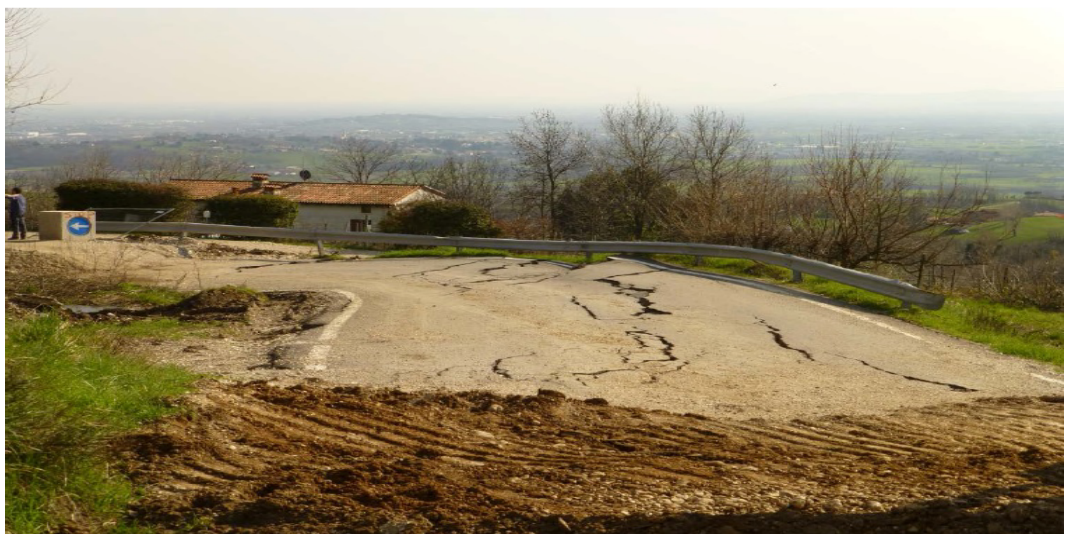
Figura 5: Strada comunale dissestata che collega Carrè e Zugliano (Fonte: Toaldo, 2014).
