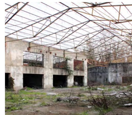
Immagine che mostra lo stato di abbandono e degrado in cui riversa lo stabile
