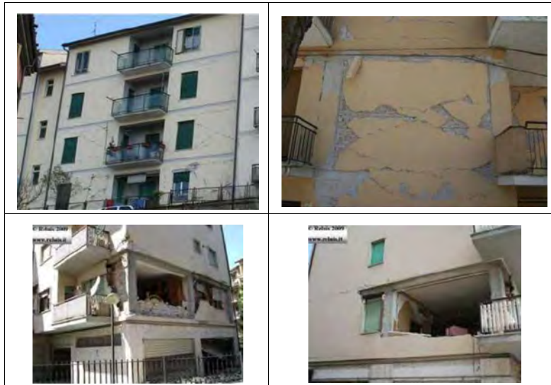
Figura 16 - Esempi di Danneggiamento dei Tamponamenti ai Piani Bassi (L'Aquila 2009).
