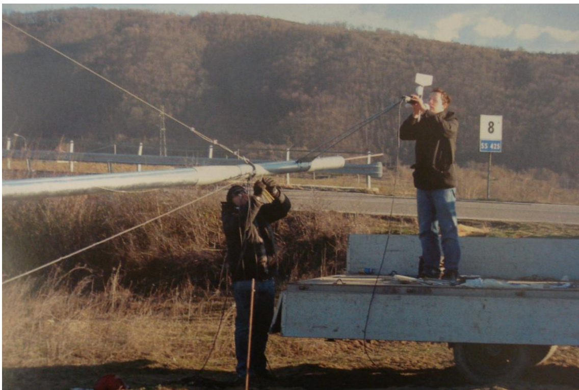
Figura 2.20 – Installazione della sensoristica
