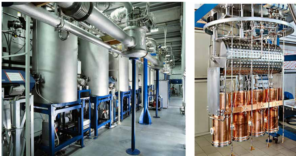
Fig. 1.18: A sinistra è rappresentato un tratto del linac ALPI. In evidenza i criostati, recipienti che contengono ed isolano termicamente dall'ambiente circostante le cavità superconduttive (a T=-269^\circ\text{C} ). L'interno di un criostato, con 4 cavità acceleranti su base di rame, è mostrato sulla destra.
