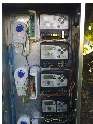
Figura 5.16: Cabina delle centraline
