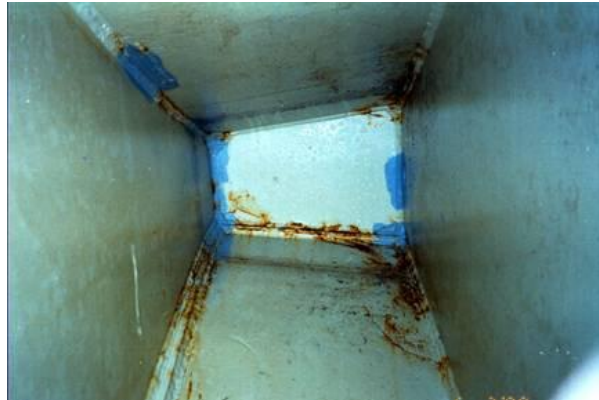
Figura 14: Pitting corrosion in una struttura saldata. Le zone blu son colorante che evidenzia le perdite nella tenuta idraulica
