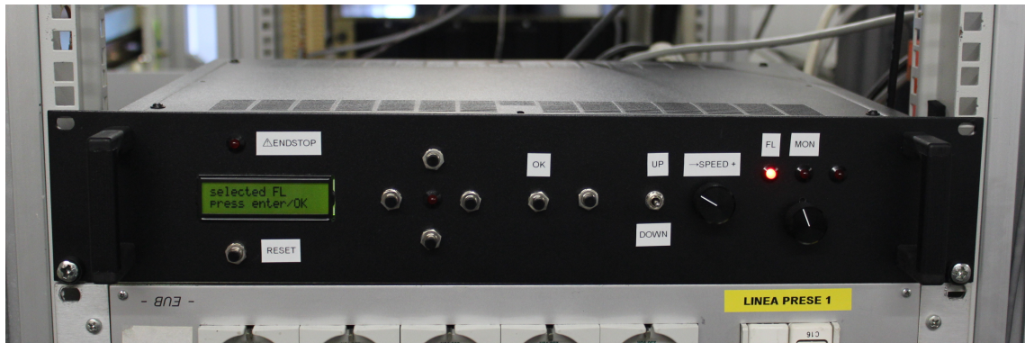
Fig. 4.27: PCB nel suo rack di alloggiamento.
