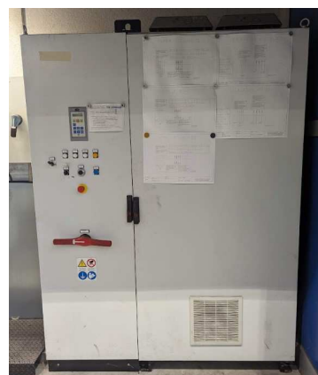
Figura 3.5: Foto quadro inverter
