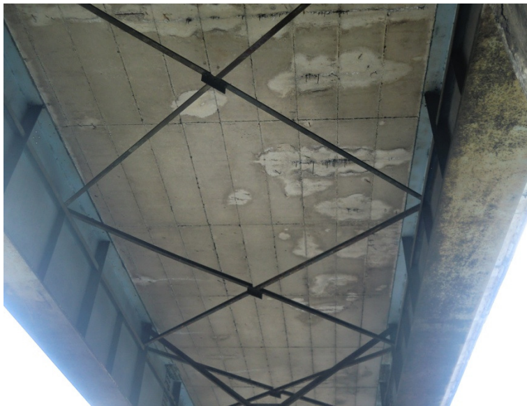
Figura 52: Soletta in c.a. - particolare macchie di umidità- VIADOTTO 1
