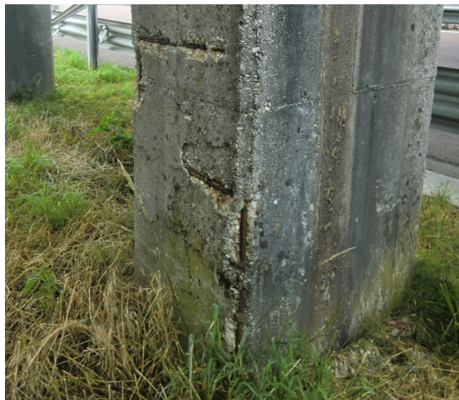
Figura 105: Pila in c.a. - particolare armatura corrosa
