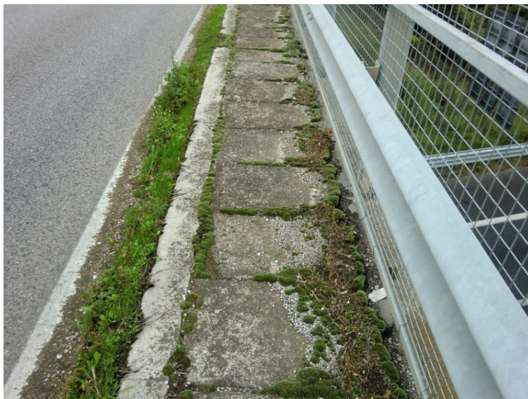
Figura 67: Dissesto generalizzato del marciapiede 2/2 - VIADOTTO 5
