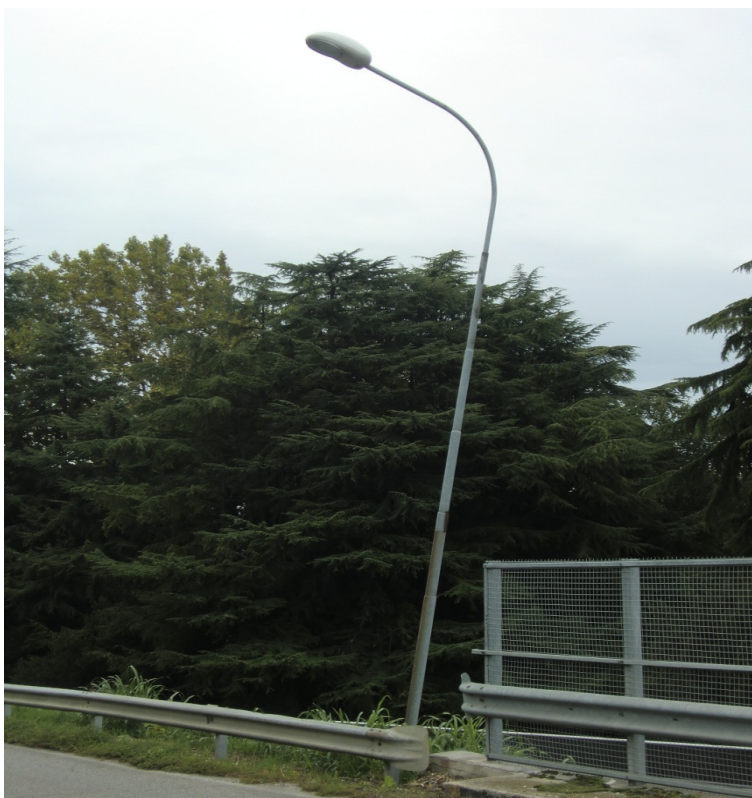
Figura 72: Palo di illuminazione male ancorato - VIADOTTO 5
