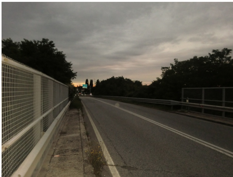
Figura 71: Illuminazione assente - VIADOTTO 5
