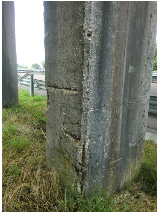
Figura 44: Vista della parte inferiore della pila: evidenti gli effetti del dilavamento e armatura corrosa - VIADOTTO 1
