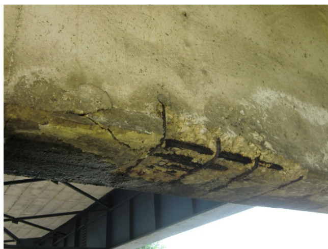
Figura 135: Pulvino in c.a. - particolare armatura corrosa
