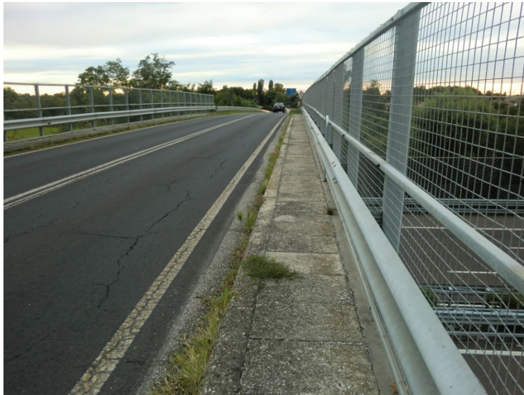
Figura 61: Fessurazione longitudinale diffusa - VIADOTTO 5
