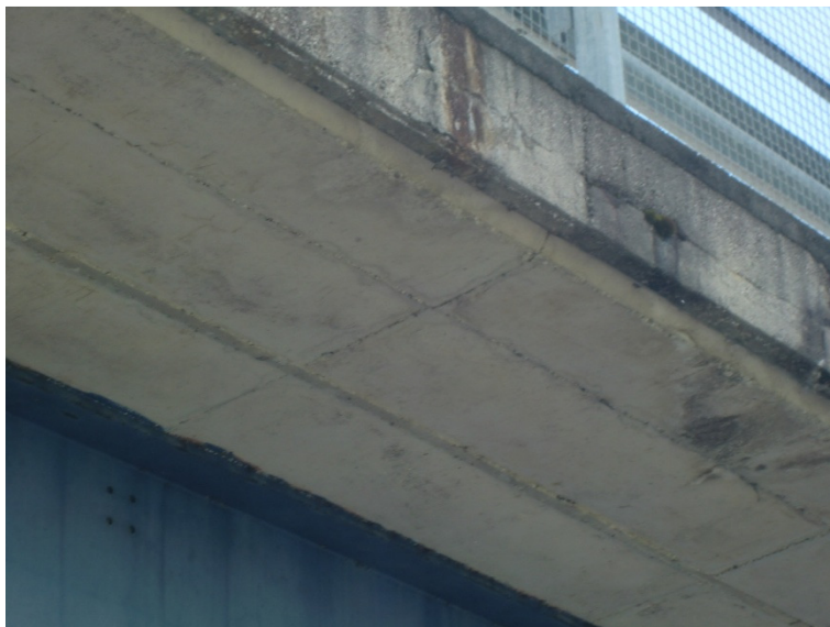
Figura 59: Assenza di gocciolatoi - VIADOTTO 2
