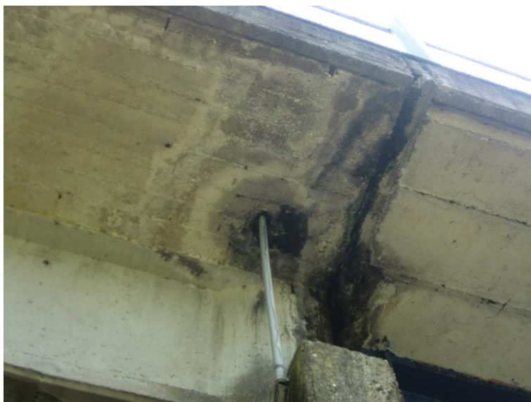
Figura 60: Pluviale per lo scarico delle acque meteoriche - VIADOTTO 2
