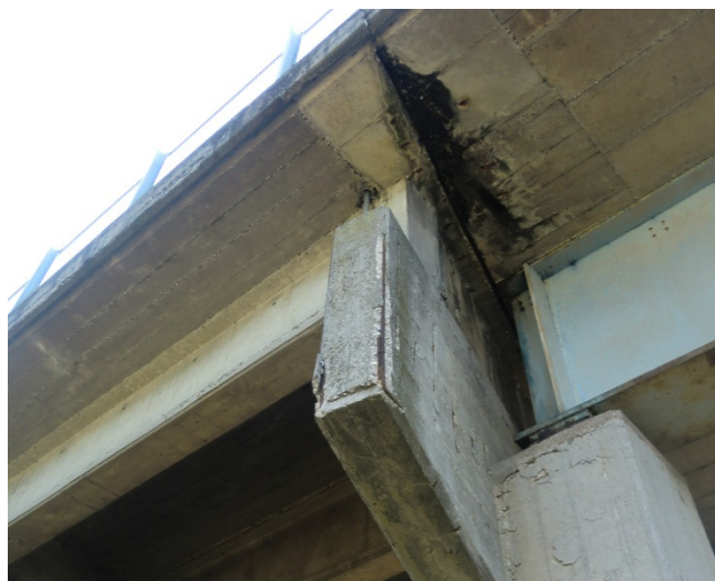
Figura 111: Soletta in c.a. - particolare zona ammalorata
