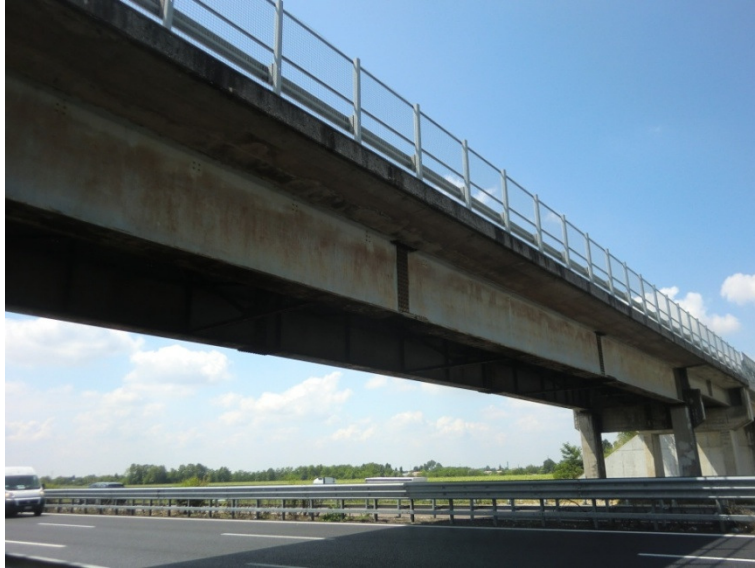
Figura 48: Travi in acciaio - danneggiamento medio riscontrato - VIADOTTO 17
