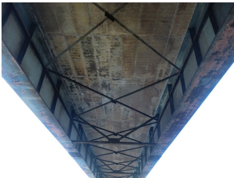
Figura 51: Soletta in c.a. – intradosso - VIADOTTO 9
