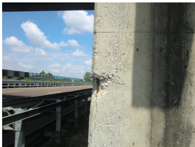
Figura 120: Pila in c.a. - particolare armatura deteriorata
