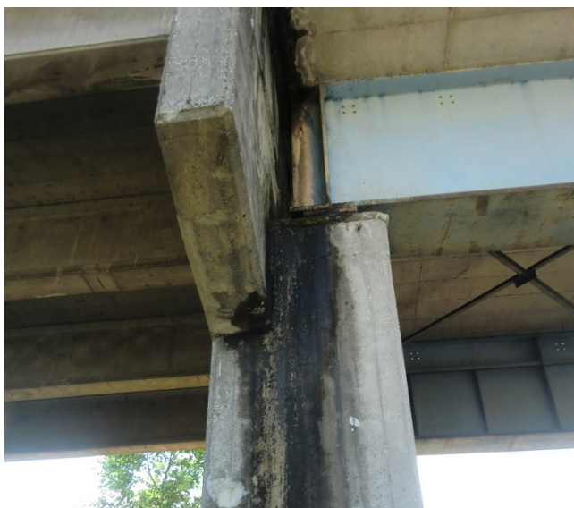
Figura 108: Pila in c.a. - particolare zona ammalorata
