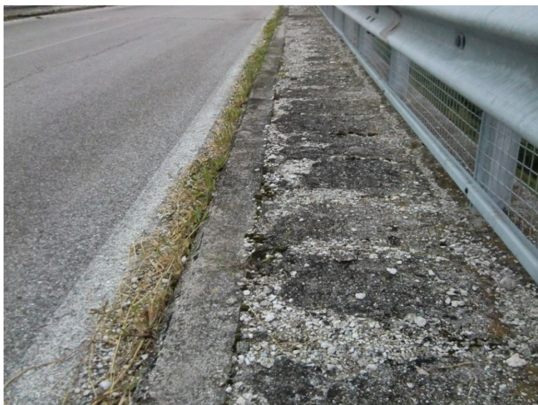
Figura 66: Dissesto generalizzato del marciapiede 1/2 - VIADOTTO 2
