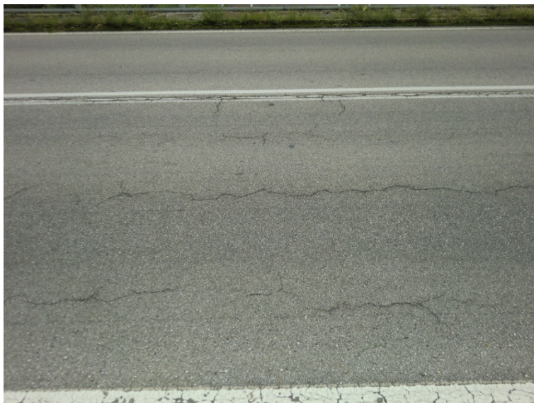
Figura 62: Particolare fessurazione - VIADOTTO 5
