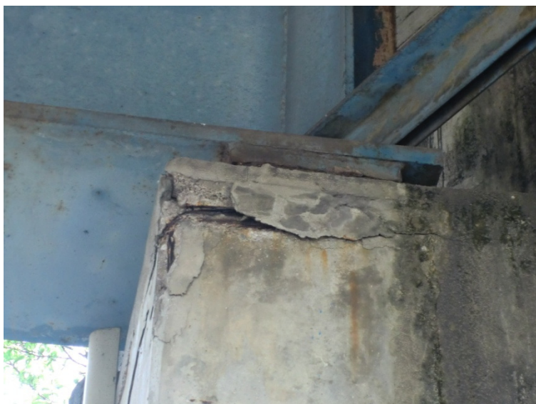
Figura 55: Deterioramento della zona di appoggio, con espulsione del copri ferro ed esposizione dell'armatura - VIADOTTO 29
