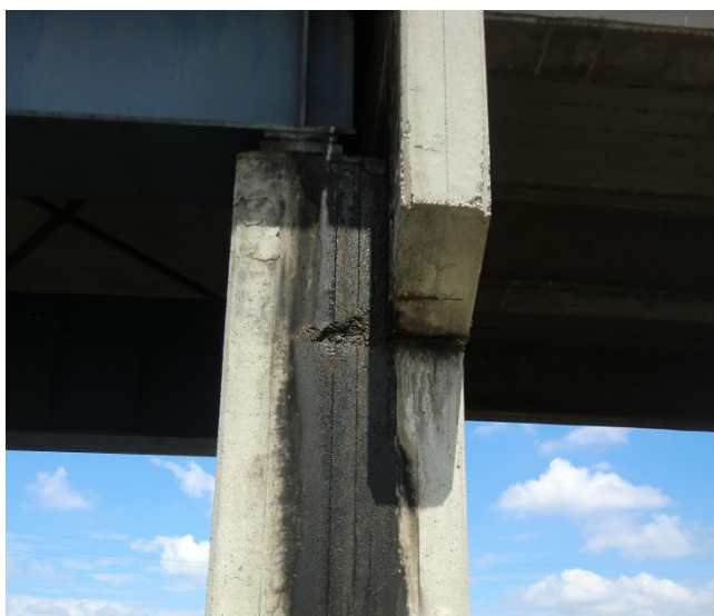
Figura 117: : Pila in c.a. - particolare zona ammalorata
