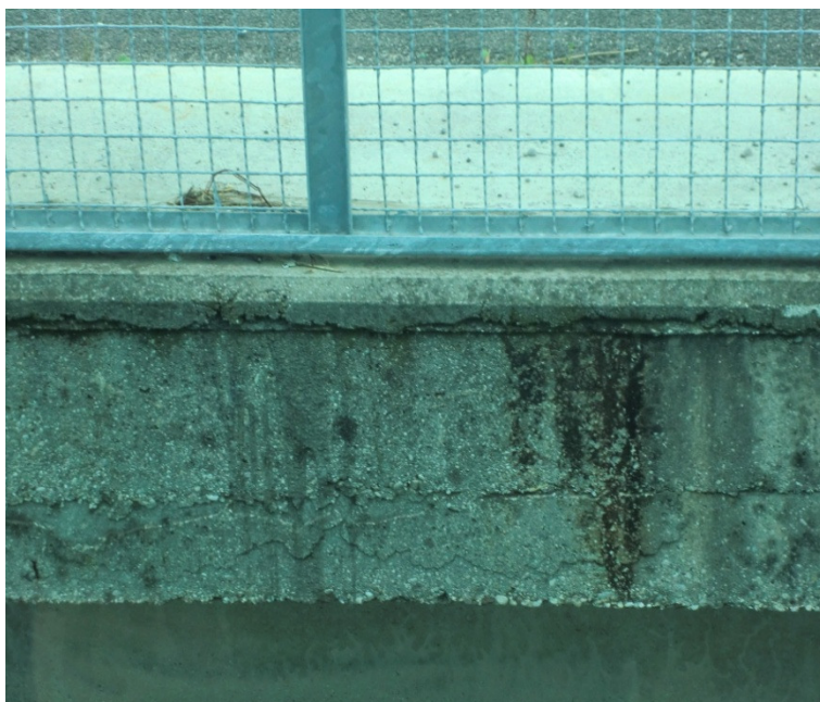
Figura 64: Particolare cordolo degradato - VIADOTTO 9
