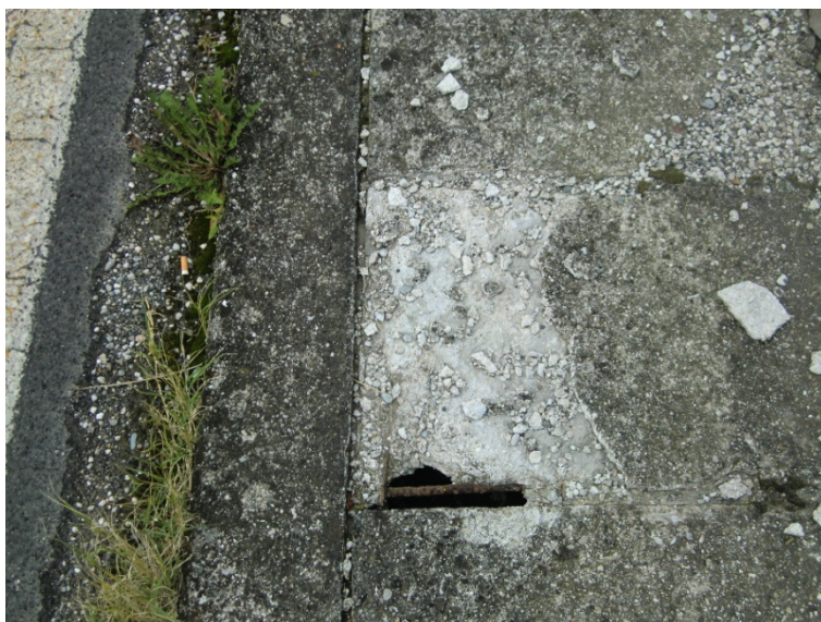
Figura 68: Particolare rottura dell'elemento prefabbricato lapideo- VIADOTTO 9
