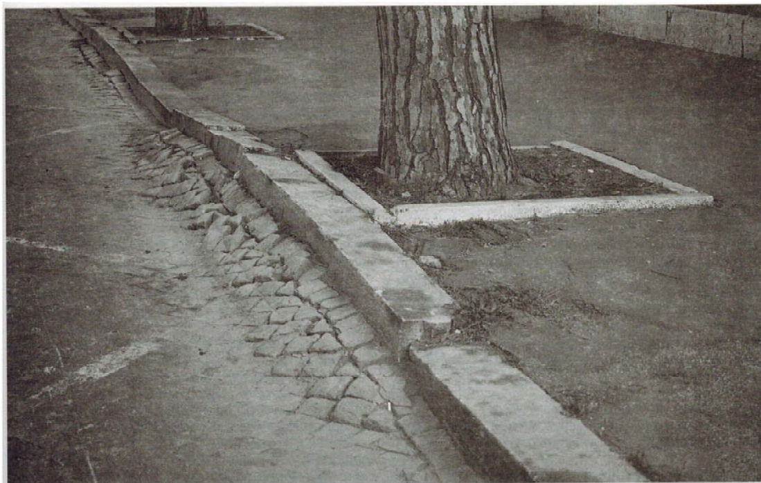
Fig. 53 – Via di San Gregorio (Roma). Sovrastruttura sconnessa per scarsa permeabilità del terreno attorno all'albero.
