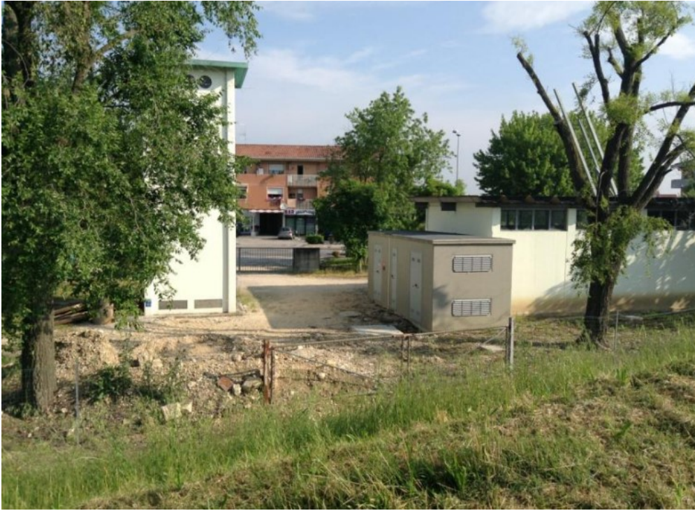
Fig. 12: Cabina in arrivo Enel, cabina di trasformazione e sala quadri
