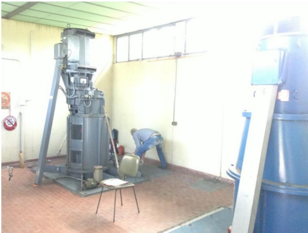
Fig. 13: Sala quadri con i due motori delle pompe
