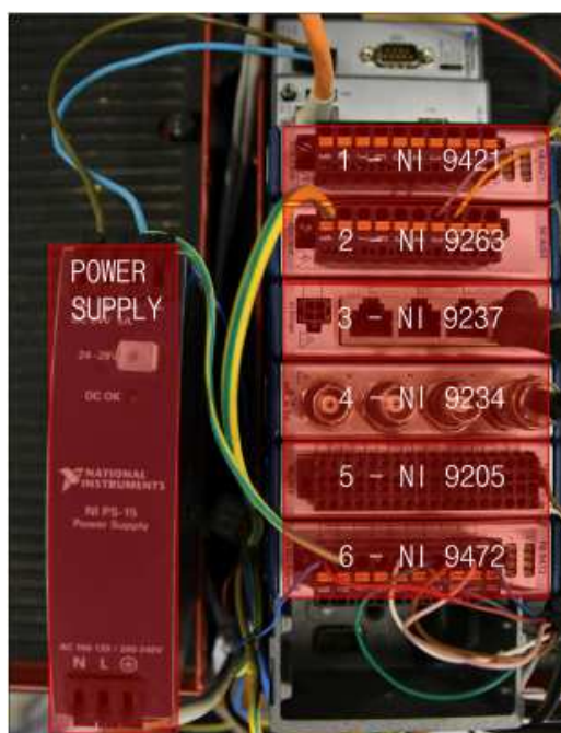
Figura 3.4 - CompactRio-9066 alimentato dal Power supply in cui sono inseriti i vari moduli I/O
