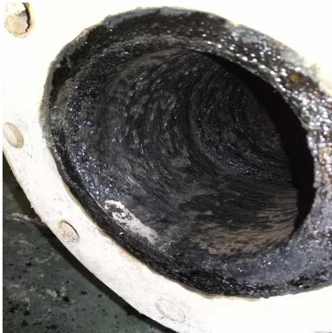
Figura 3.10: stato dello scambiatore di calore lato gas dopo apertura delle curve
