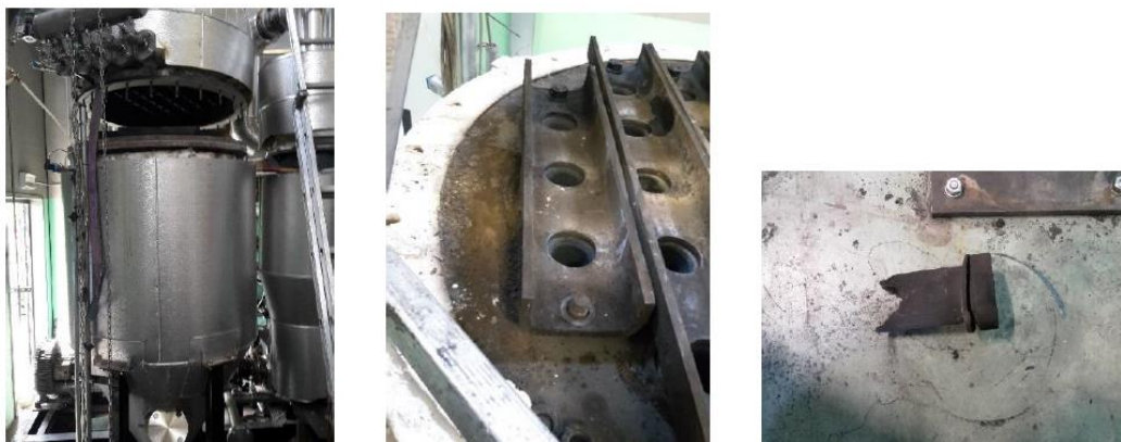
Figura 4.10: supporti deformati e presenza candela rotta
