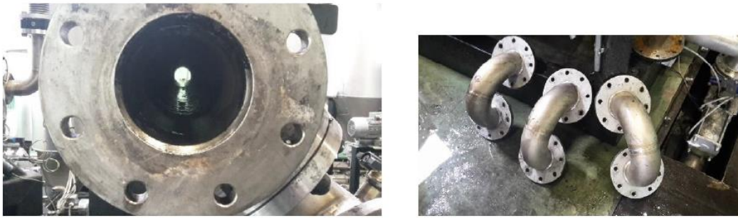
Figura 4.13: stato dello scambiatore dopo intervento di pulizia
