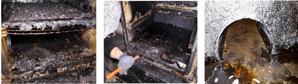
Figura 4.11: pulizia catrami filtro secondario
