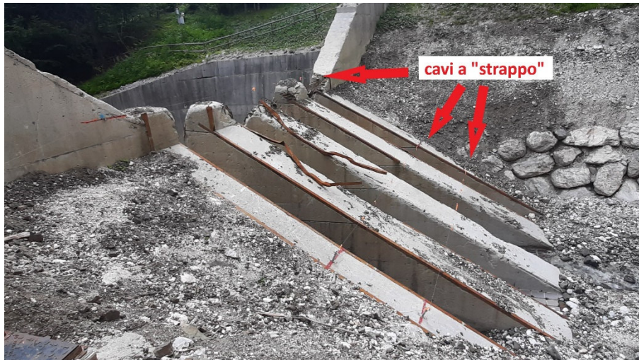
foto n.17– Sensori a cavo a “strappo” posizionati sulla rampa di monte della briglia frangicolata sul torrente Rio Rudan (foto dell’autore).
