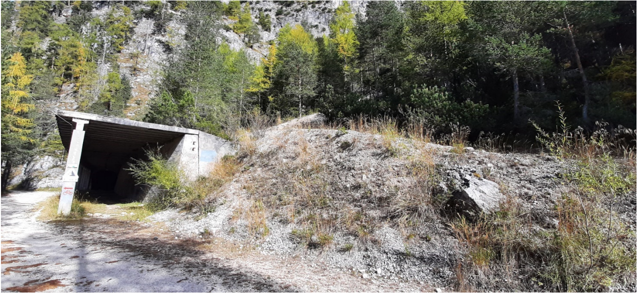
foto n.27 – Deposito detritico del canale C19 a ridosso della struttura paramassi della galleria dell'ex ferrovia Cortina – Dobbiaco, si nota la vegetazione pioniera che indica una inattività apparente della colata detritica in questa zona. (foto dell'autore).
