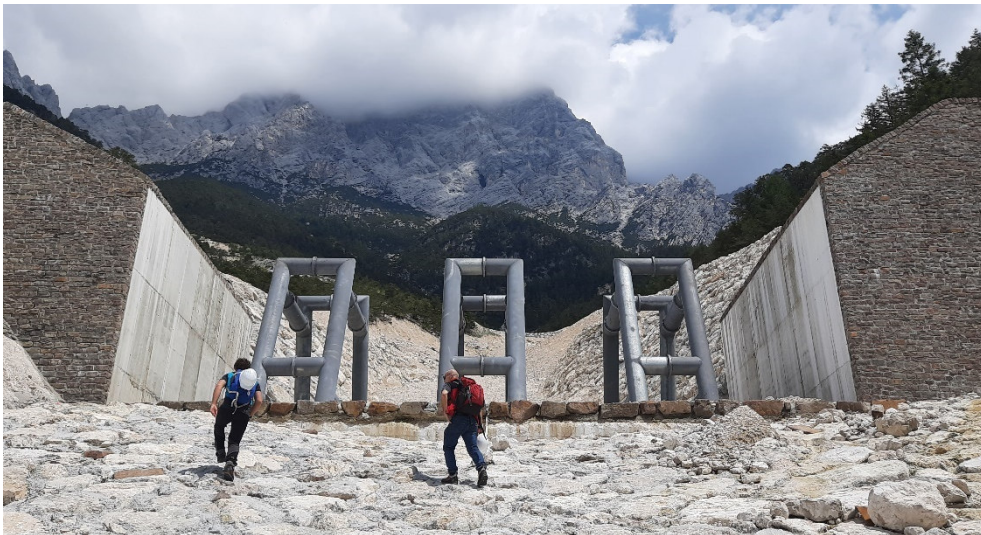
foto n.5 – Briglia frangicolata con elementi tubolari in acciaio nella Rovina di Cancia, Borca di Cadore (foto dell'autore).
