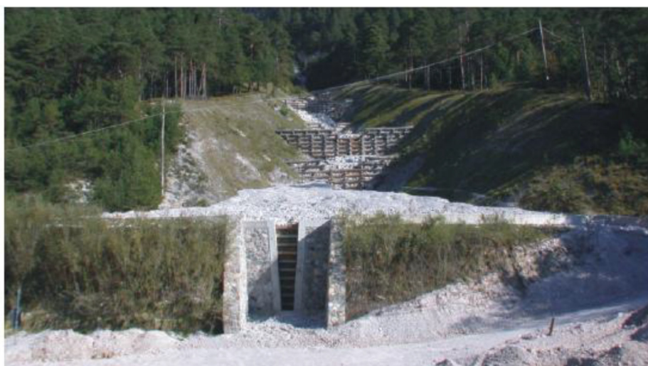
foto n.14 – Piazza di deposito completamente riempita di sedimenti (alluvione Friuli del 29 agosto 2003, Ugovizza).
