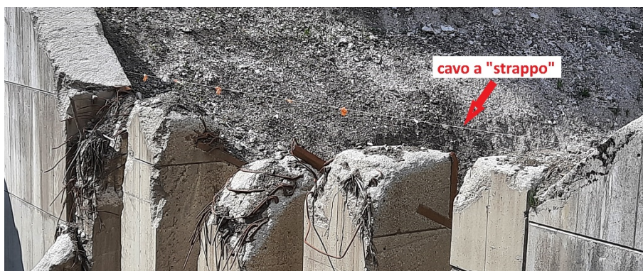
foto n.16 – Sensore a cavo a "strappo" posizionato sulla sommità della briglia frangicolata sul torrente Rio Rudan, da notare le teste degli speroni interessati dall'erosione di un precedente evento di colata (foto dell'autore).
