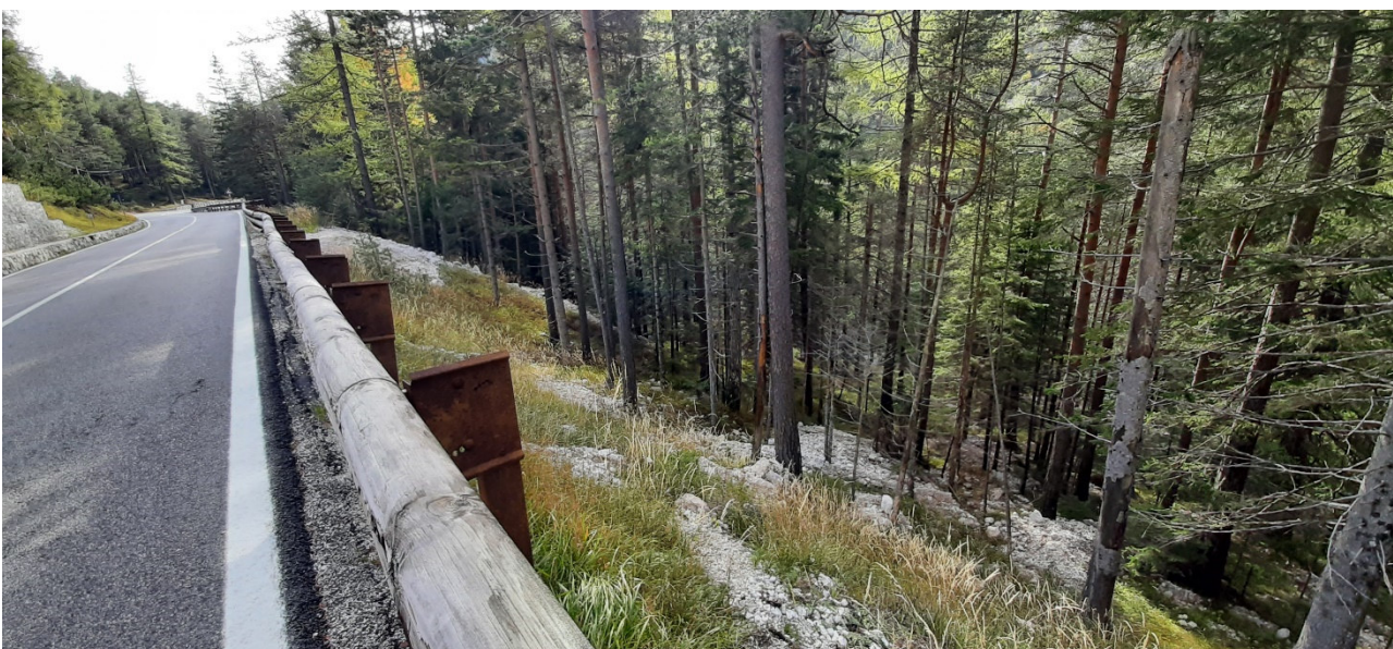
Foto n.32 – Parte di colata detritica che ha oltrepassato la strada nell'evento dell'agosto 2022 (foto dell'autore).
