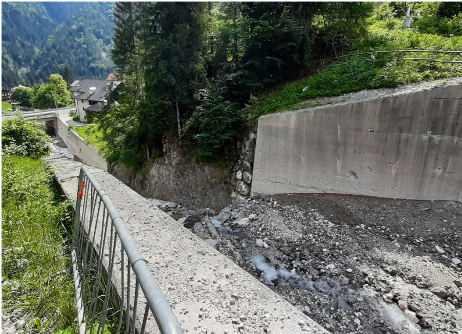
foto n.2 – Cunettone posto subito dopo la briglia frangicolata sul Rio Rudan, Vodo di Cadore (foto dell'autore).
