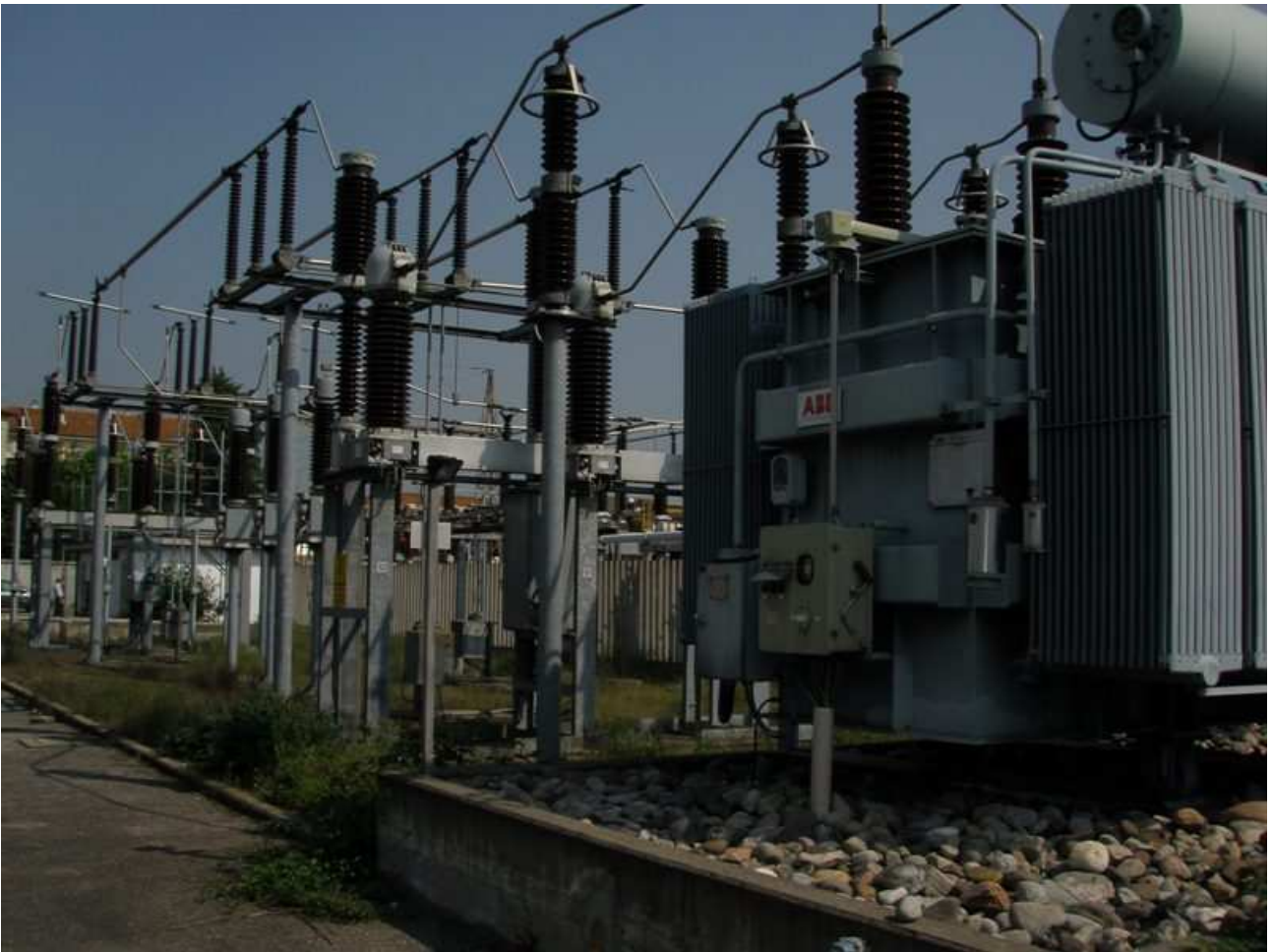
Vista di una cabina primaria 132-150 kV, dove si possono distinguere: un trasformatore di potenza, un interruttore AT tripolare, un sezionatore tripolare con lame terra, tre trasformatori di corrente, tre scaricatori AT, tre trasformatori di tensione induttivi
