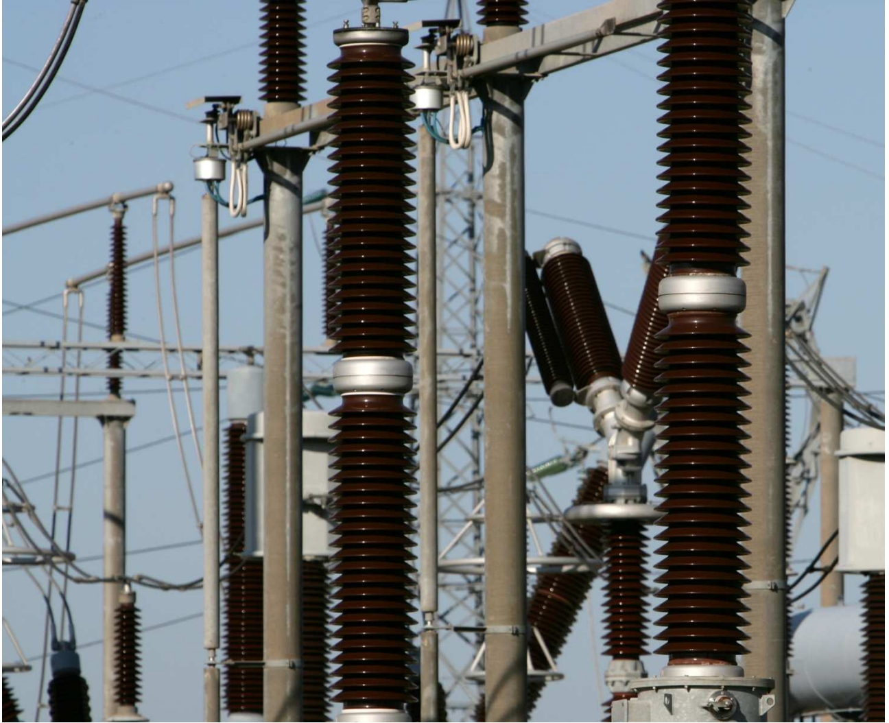
Organo di manovra che realizza la disconnessione, anche sotto carico, della linea dalle sbarre di stazione: “interruttore”
