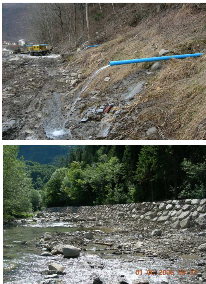
Fig. 4-7: Interventi effettuati sul corpo di frana; (a) posa dei drenaggi orizzontali; (b) la scogliera arginale in massi. [foto Servizio Geologico].
