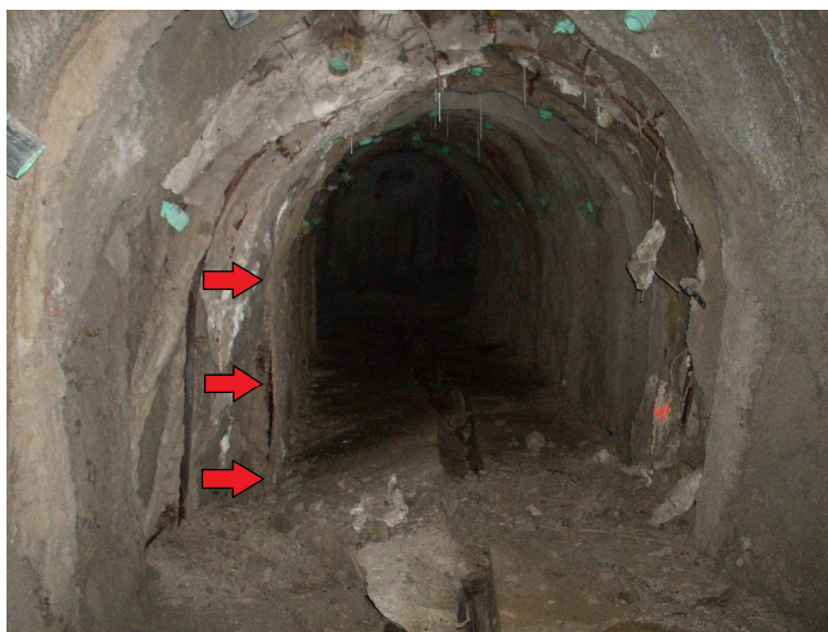
Fig. 4-19: La galleria di drenaggio nei pressi del municipio. Si nota il dislocamento delle pareti laterali ad opera delle spinte di monte.
