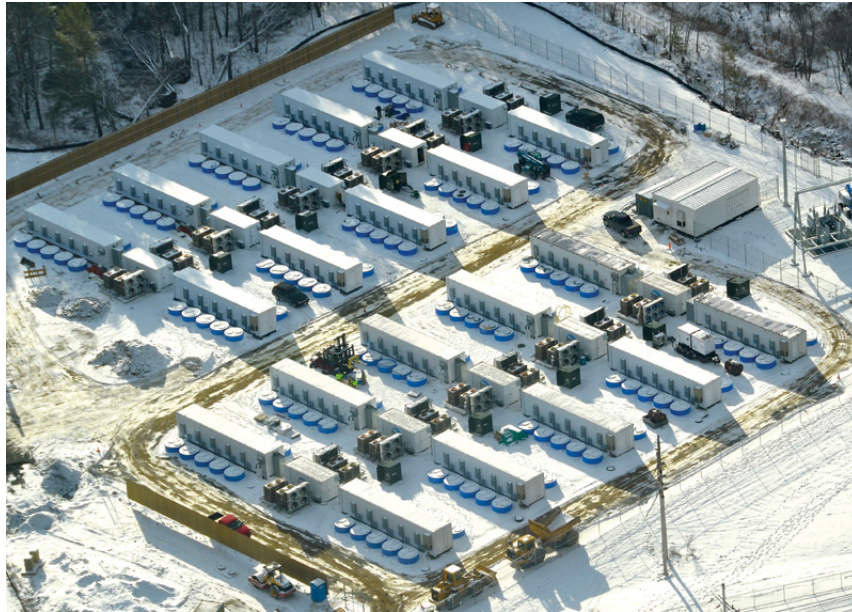
Figura 18: Impianto per la regolazione della frequenza da 20MW che utilizza 200 batterie a volano interrate da 100kW/25kWh [32]
