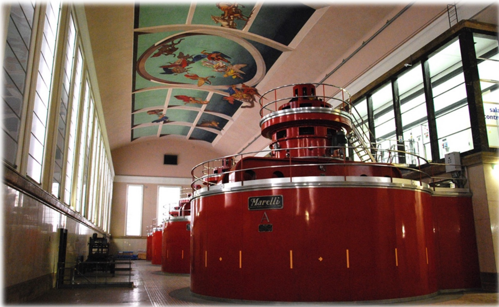
Centrale Achille Gaggia di Soverzene vista sala macchine - Veneto
