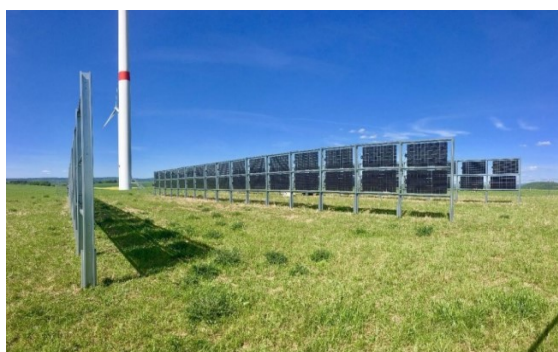
Sistema fisso a disposizione verticale dei pannelli, Germania.
