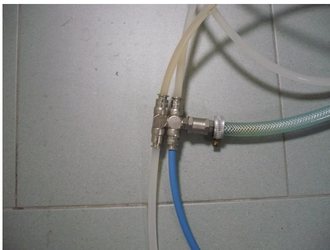
Figura 28: Raccordo per i tubi dell'acqua di uscita dalla lampada nel tubo tigrato.
