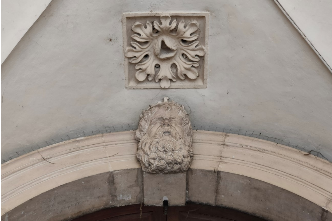
Fig. 72 – Palazzo Cumano, ora Liceo Ippolito Nievo, Padova, via San Gregorio Barbarigo. Dettaglio della chiave di volta con mascherone dell’arco d’ingresso e dello spioncino zenitale.
