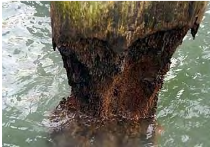
Figura 4.2.1.1: Esempio di degrado causato da organismi Xilofagi
